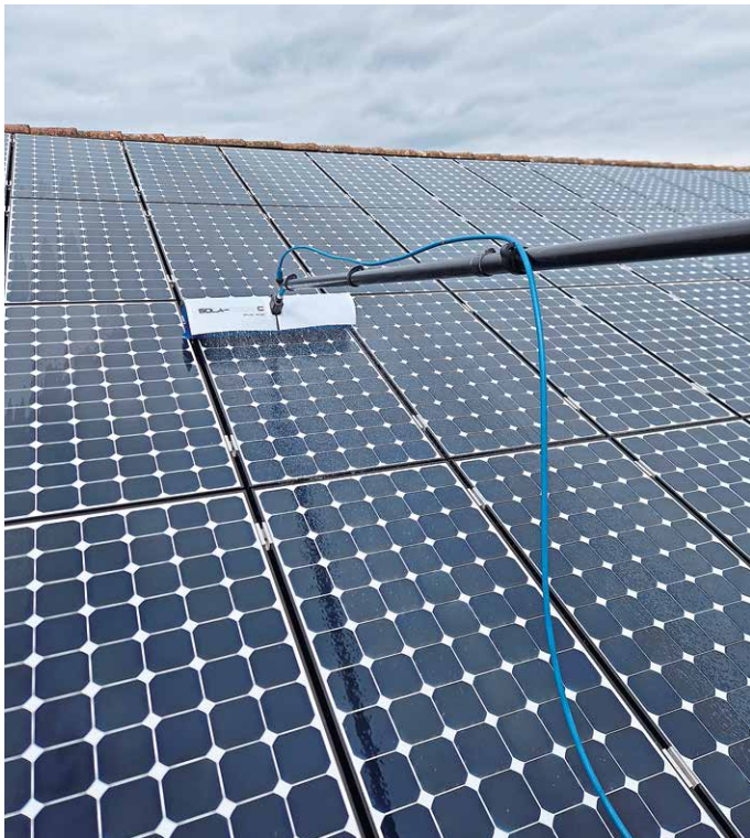
Reinigung einer Solaranlage mit einem mobilen, mit Wasser angetriebenen Bürstenwalzen-System.
